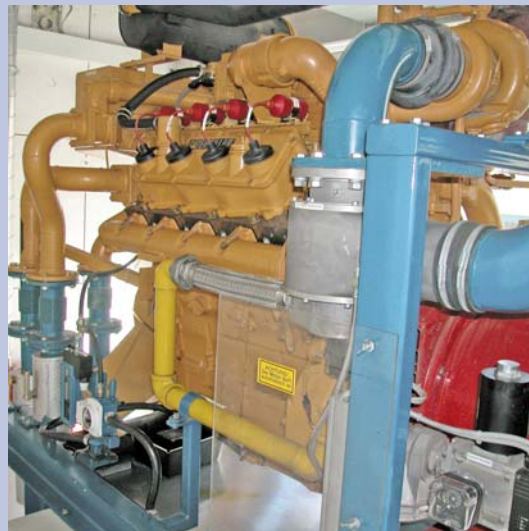
De WKK-installatie van de warmtekrachtcentrale van IVF HARTMANN AG/Zwitserland garandeert een efficiënt gebruik van energie.
